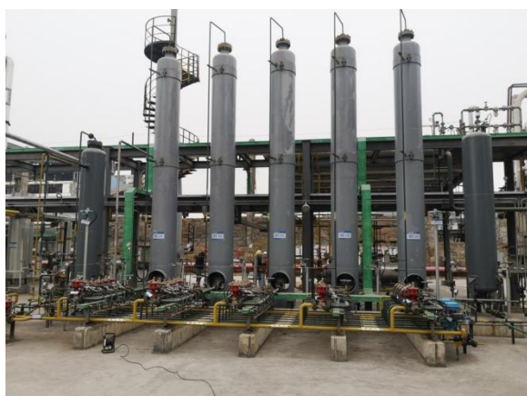
图 3-5 制氢装置吸附塔
