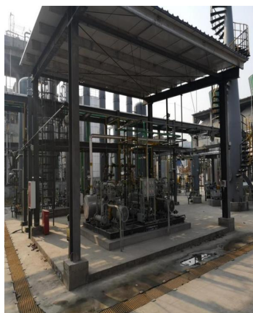
图 3-4 制氢装置天然气压缩机组
