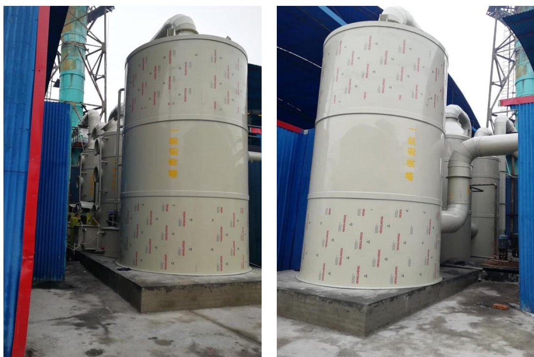
图 3-4 水解、压滤工段硫化氢处理装置
