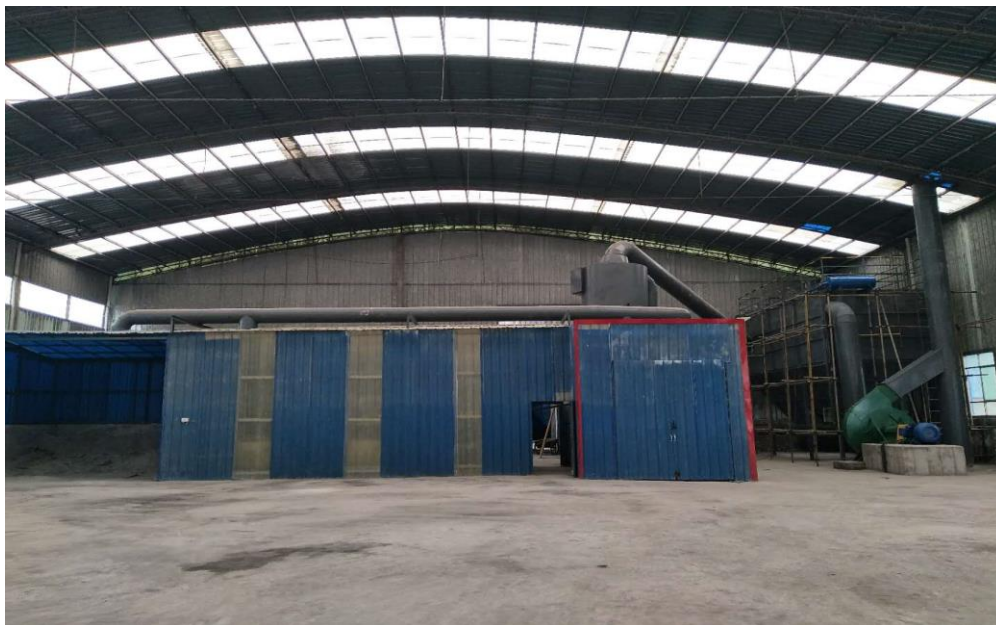
图 3-3 原料上料、破碎工段布袋除尘器
